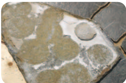
Eksempel på dårlig limdekning.
