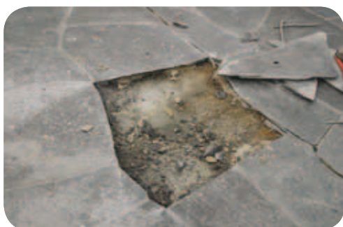
Eksempel på frostsprengning.
