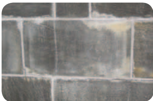
Eksempel på salt- og kalkutslag.
